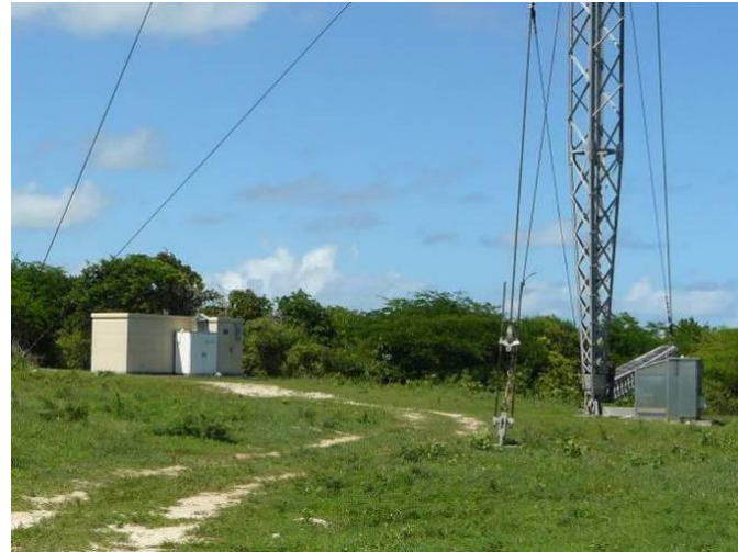
Figure 55 : Vues rapprochées sur les installations au sol des éoliennes de Fonds Caraïbes
