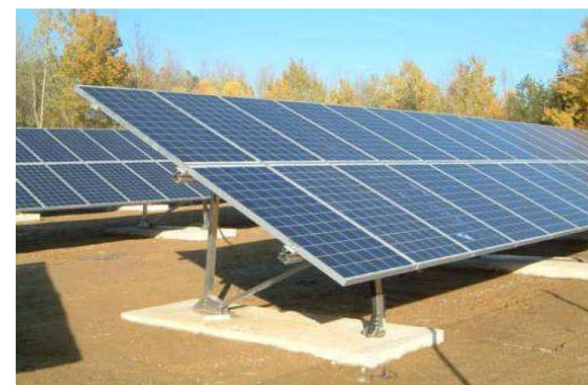
Figure 14 : Exemple d'une centrale photovoltaïque au sol
