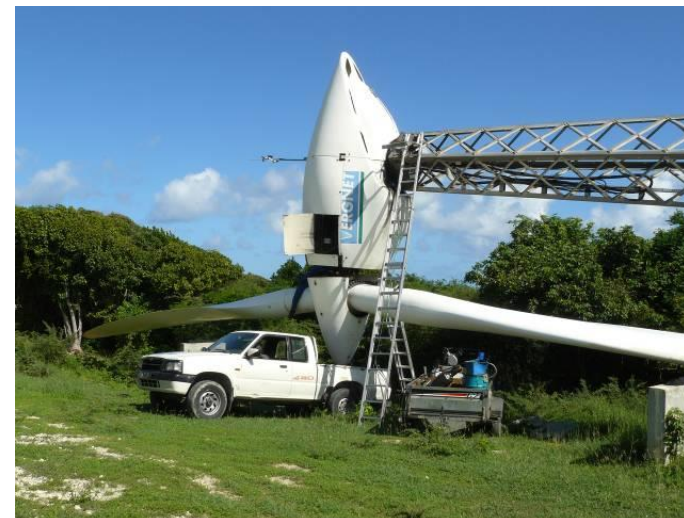
Figure 31 : Maintenance au sol des éoliennes
