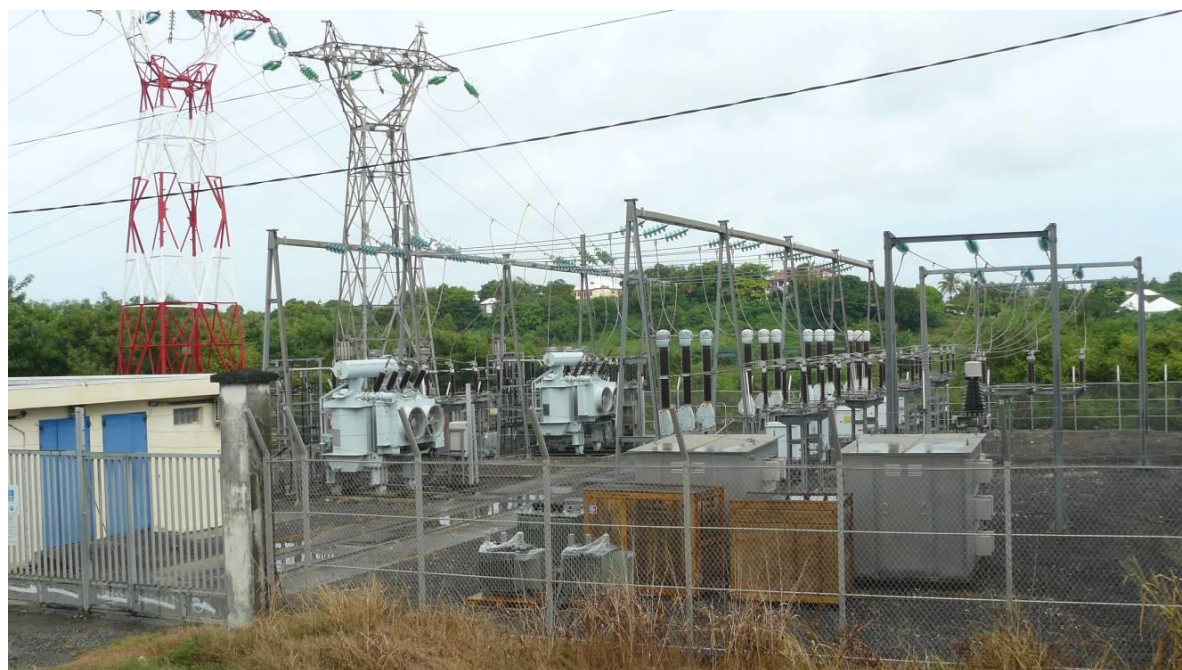
Figure 28 : Poste source de Saint François
