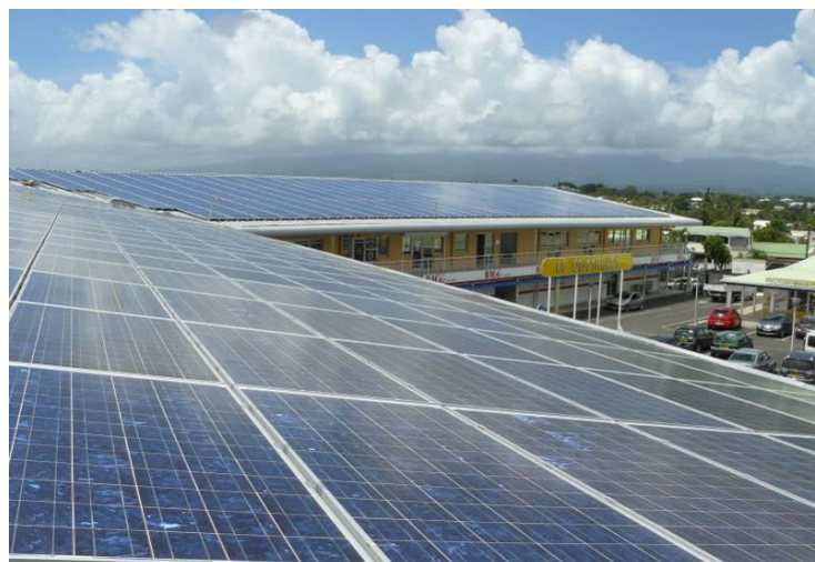
Figure 13 : Exemple de centrale photovoltaïque en toiture
