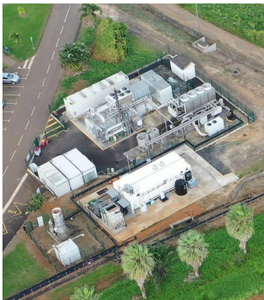
Figure 12 : zone technique de traitement des effluents – au premier plan, nouvelle station de traitement des lixiviats, et torchère / vapo-therm, et moteur de valorisation du biogaz en arrière-plan
