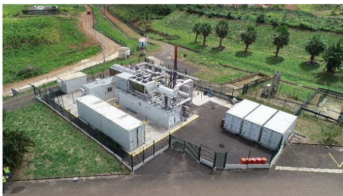
Figure 15 - Vue d'ensemble de la plateforme de valorisation biogaz
