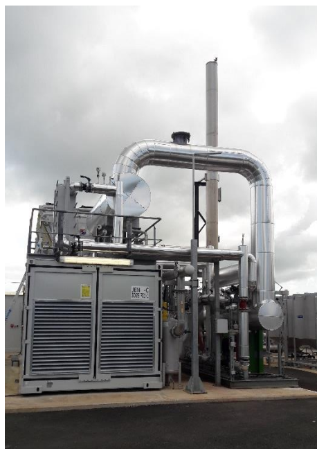
Figure 16 - Vue de détail de la plateforme de valorisation biogaz
