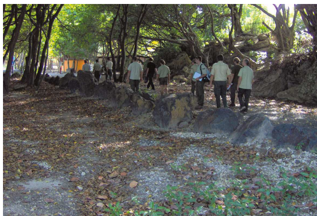
FDL Martinique, enrochement efficace, mais peu intégré à l'environnement ( Photo ONF Guadeloupe)
