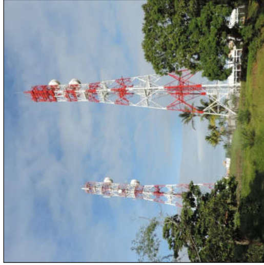
Figure 52 : Photographie des pylônes Orange. (Source : ANC Concept)
