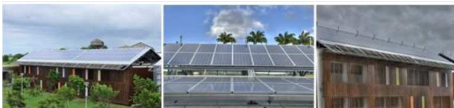
Figure 52 Exemple d'installations photovoltaïque - Source Guadeloupe Énergie
