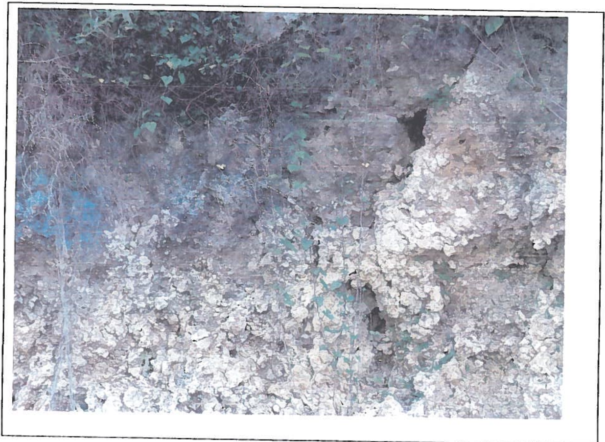
Instabilité de la paroi
