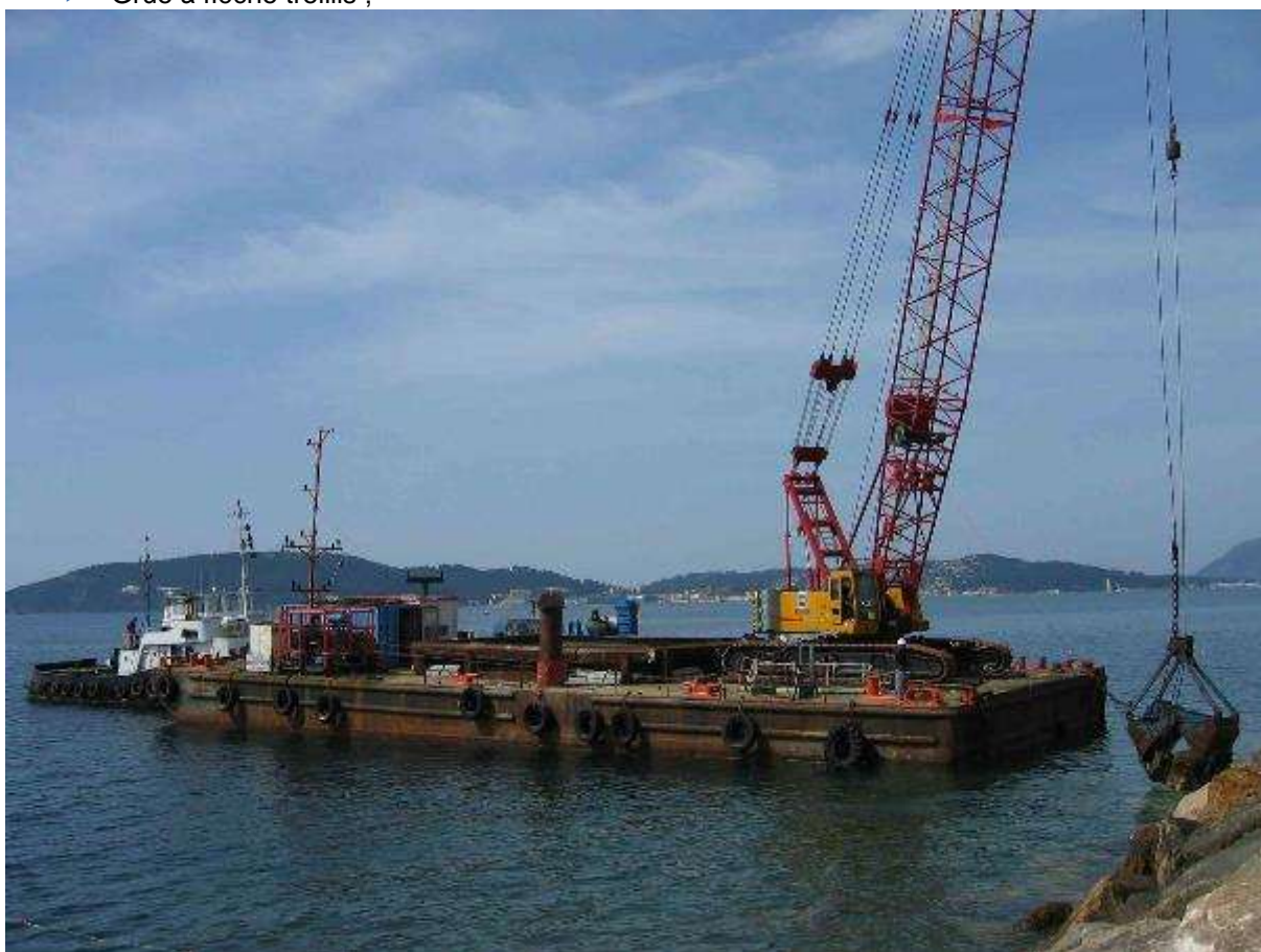
Figure 20 : illustration de travaux maritimes réalisés via une barge et une grue à flèche treillis
