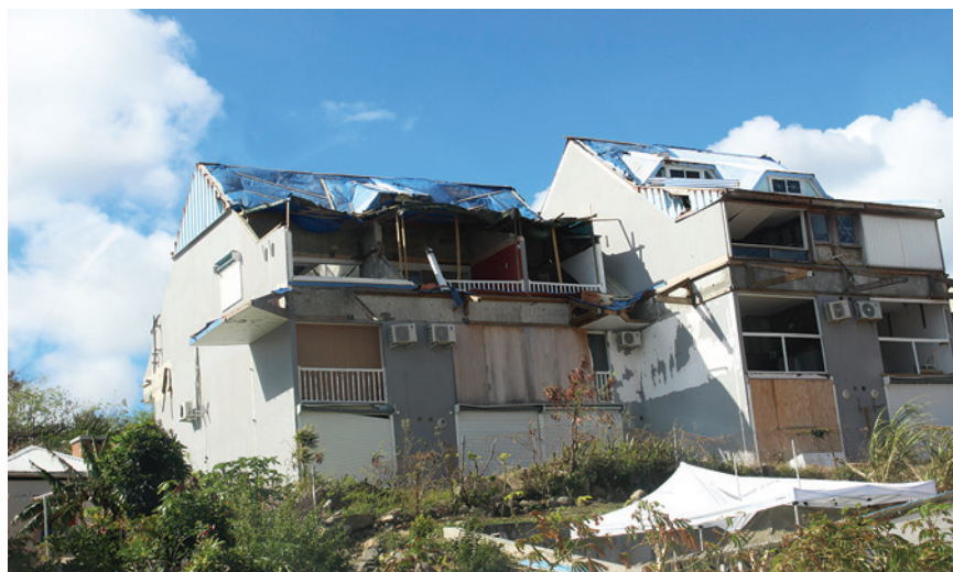
Figure 3 : Désordres sur parties légères d'ouvrages maçonnés
