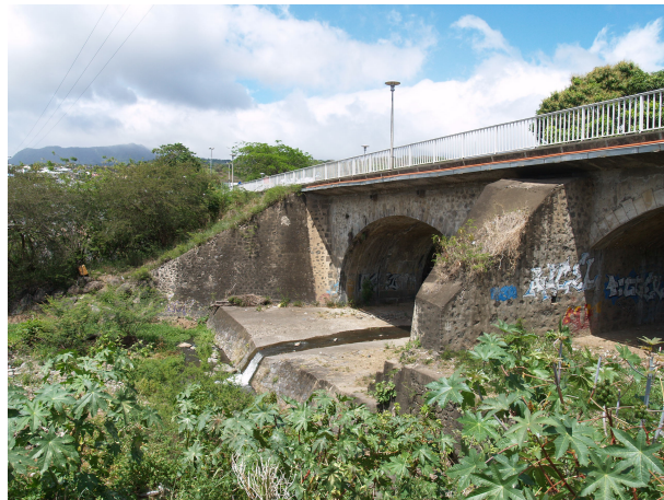
Seuil infranchissable en aval de la rivière des pères
