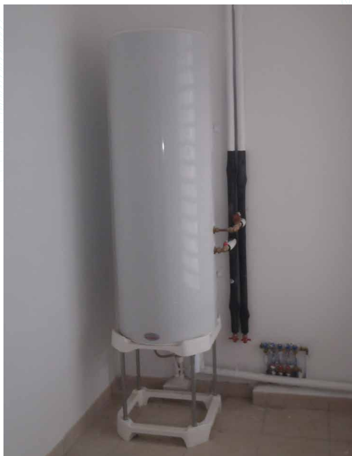
Ballon d'eau chaude sanitaire
