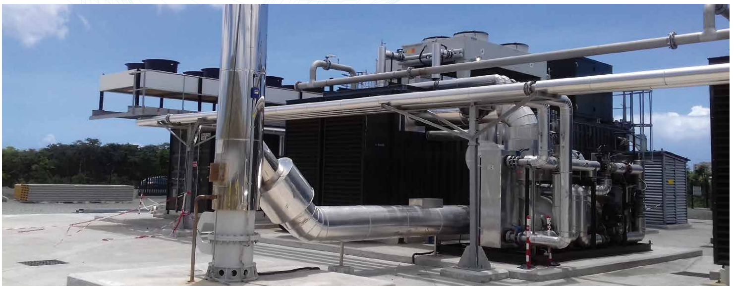
Centrale biogaz Gabarre
