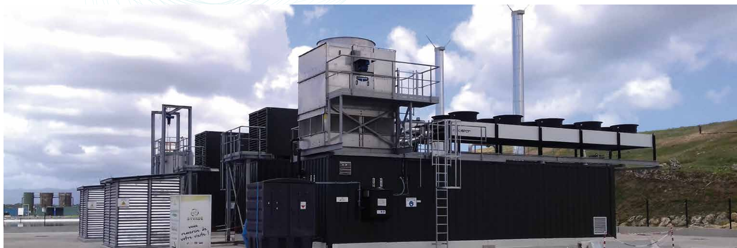
Centrale biogaz Gabarre
