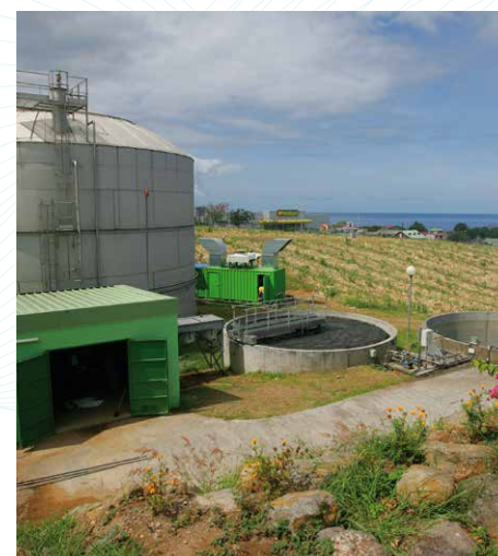
Unité de méthanisation - Distillerie Bologna
