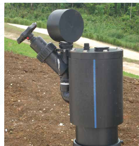
Puits de méthane - Gabarre
