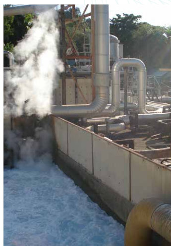
Centrale géothermique de Bouillante
