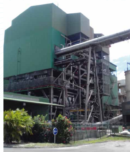
Centrale thermique Albioma
