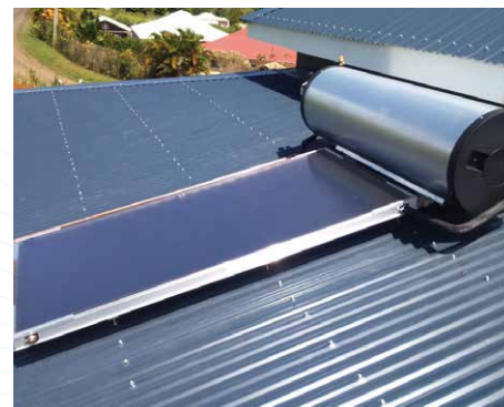
Chauffe eau solaire
