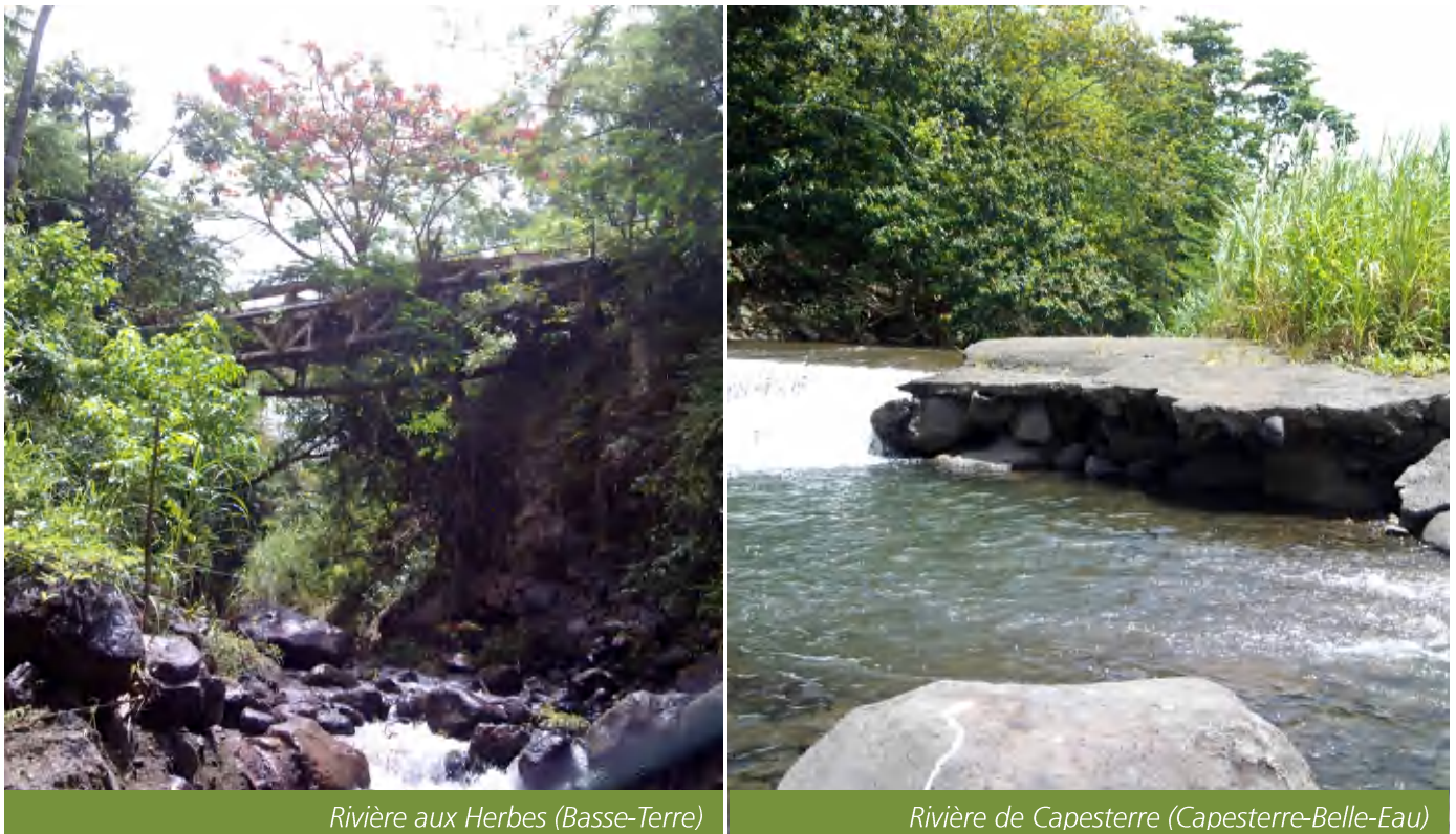
Figure 11 : Photographies d'une des passerelles et du barrage dégradé observés en 2018
