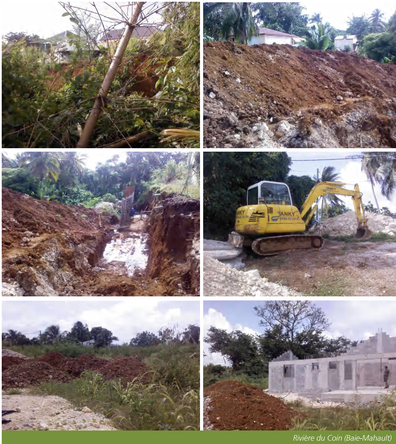
Figure 14 : Photographies des travaux de remblaiement observés sur la Rivière du Coin à Baie-Mahault
