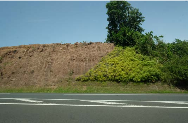
N1 - Goyave / Talus en déblai soumis à l'érosion superficielle
