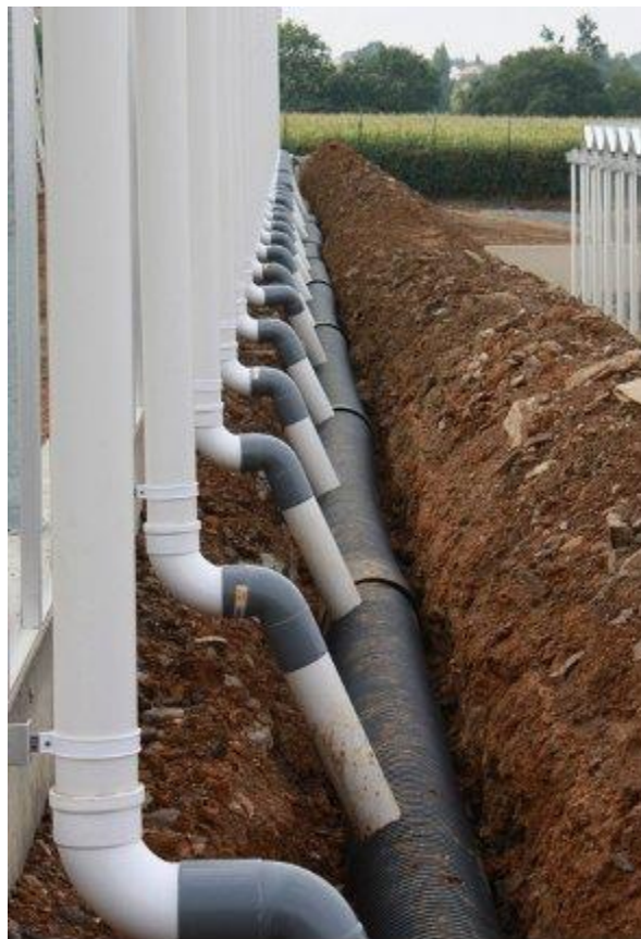
Collecte des eaux de pluies : acheminement jusqu'au bassin de rétention
