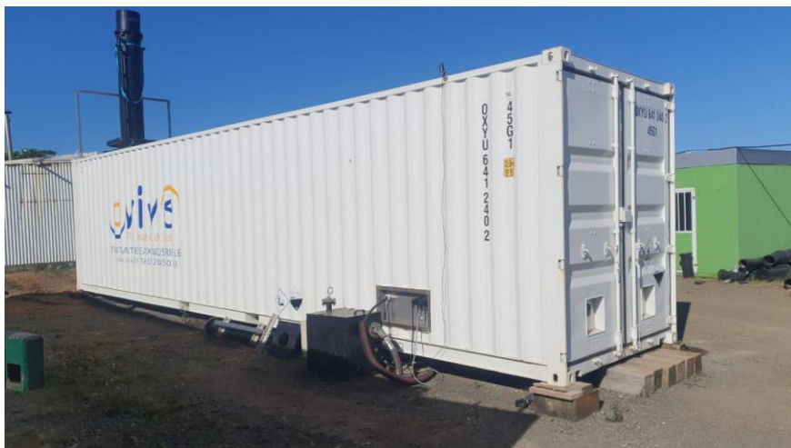
Figure 16 : Photo de la troisième station de traitement
