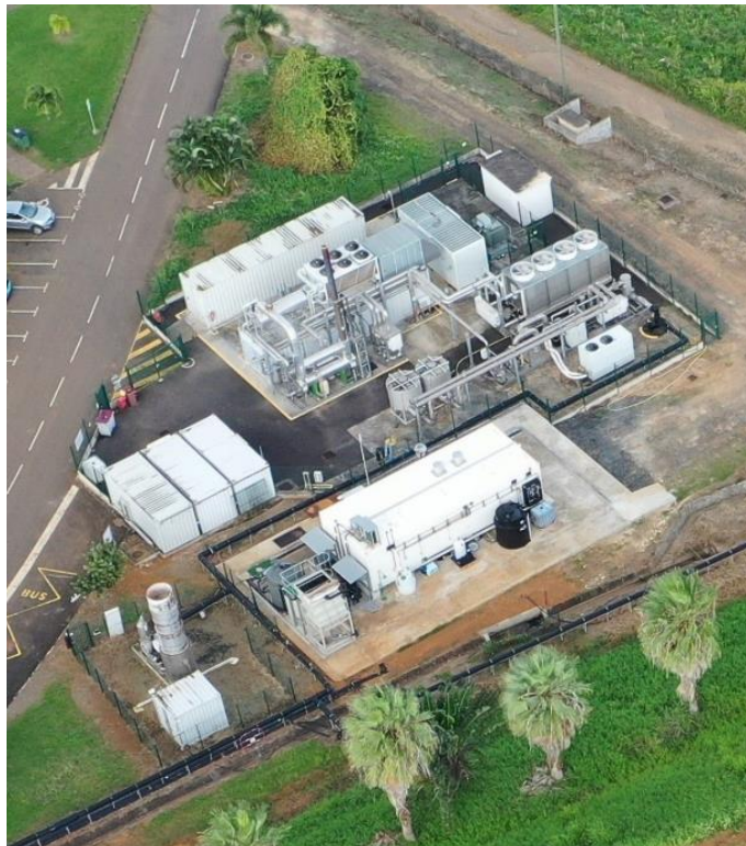
Figure 13 : zone technique de traitement des effluents – au premier plan, nouvelle station de traitement des lixiviats, et torchère / vapo-therm, et moteur de valorisation du biogaz en arrière-plan
