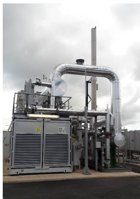
Figure 18 - Vue de détail de la plateforme de valorisation biogaz
