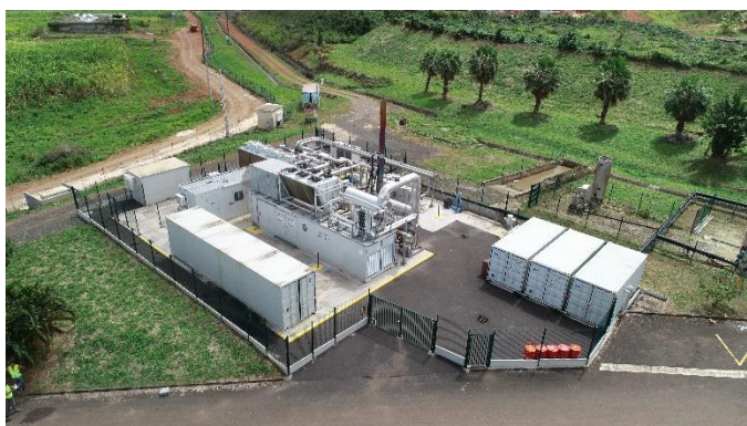
Figure 17 - Vue d'ensemble de la plateforme de valorisation biogaz
