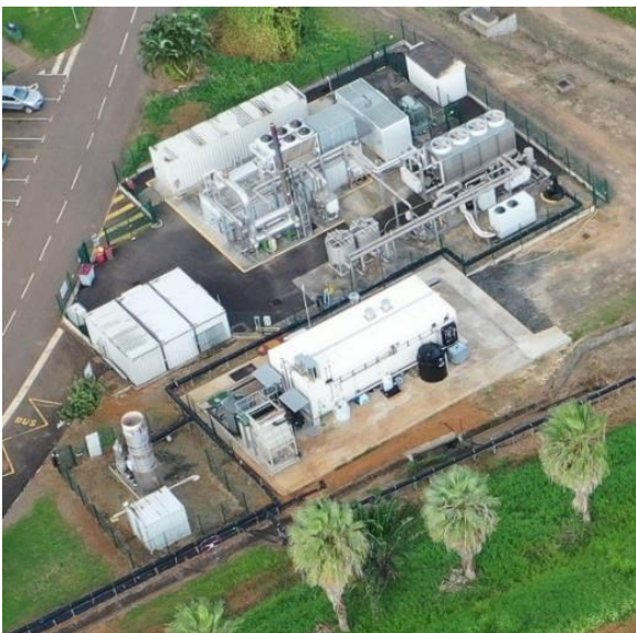
Figure 13 : zone technique de traitement des effluents – au premier plan, station de traitement des lixiviats Biome, et torchère / vapo-therm, et moteur de valorisation du biogaz en arrière-plan
