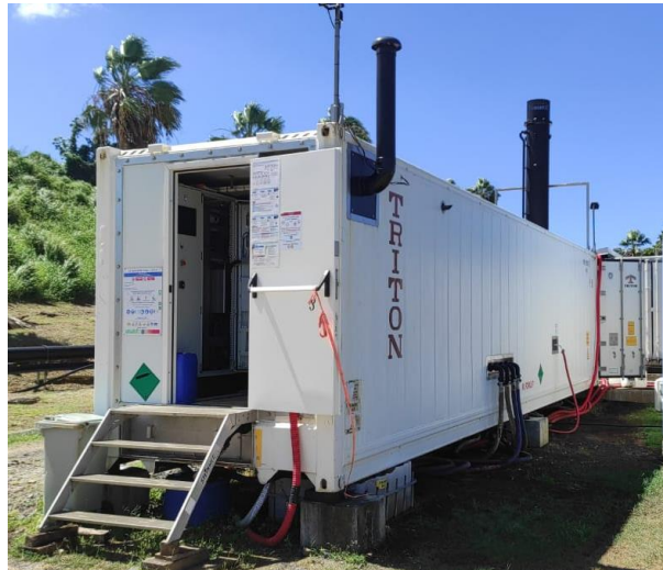
Figure 16 : Photo de la troisième station de traitement
