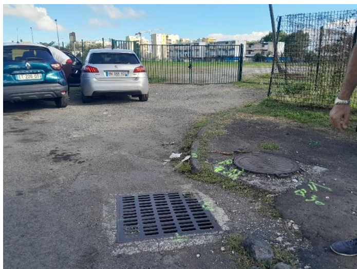
Figure 18. Avaloir pluvial en entrée de site (Source : FILAO Ingénieurs Conseils)
