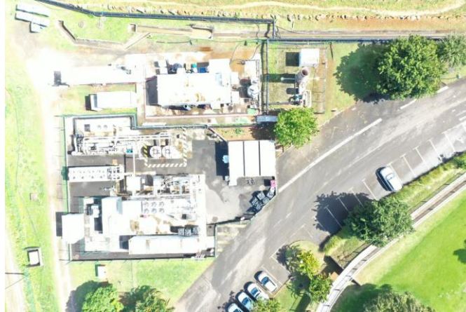
Figure 13 : zone technique de traitement des effluents – station des traitement des lixiviats Biome et Ovide, torchère / vapo-therm, et moteur de valorisation du biogaz en arrière-plan
