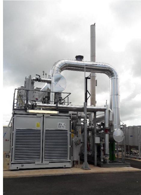
Figure 18 - Vue de détail de la plateforme de valorisation biogaz
