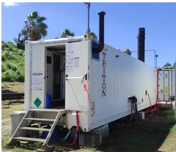
Figure 16 : Photo de la deuxième station de traitement
