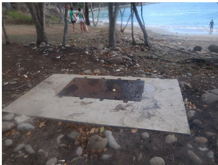
Figure 4 : Vue de la chambre de plage de raccordement déjà installée (Terre-de-Haut, Les Saintes)
