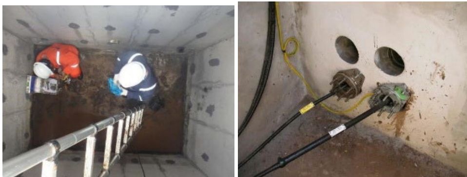
Figure 10 : Intérieur d'une chambre-plage et bride d'ancrage d'un câble
