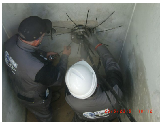
Figure 20 : Intérieur d'une chambre de plage
