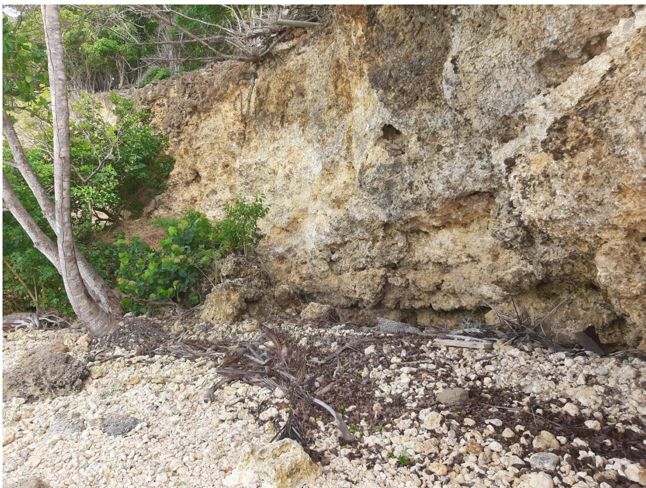
Photo 4 : Portion de falaise, à l'Ouest. Observation d'un phénomène de sous-cavement
