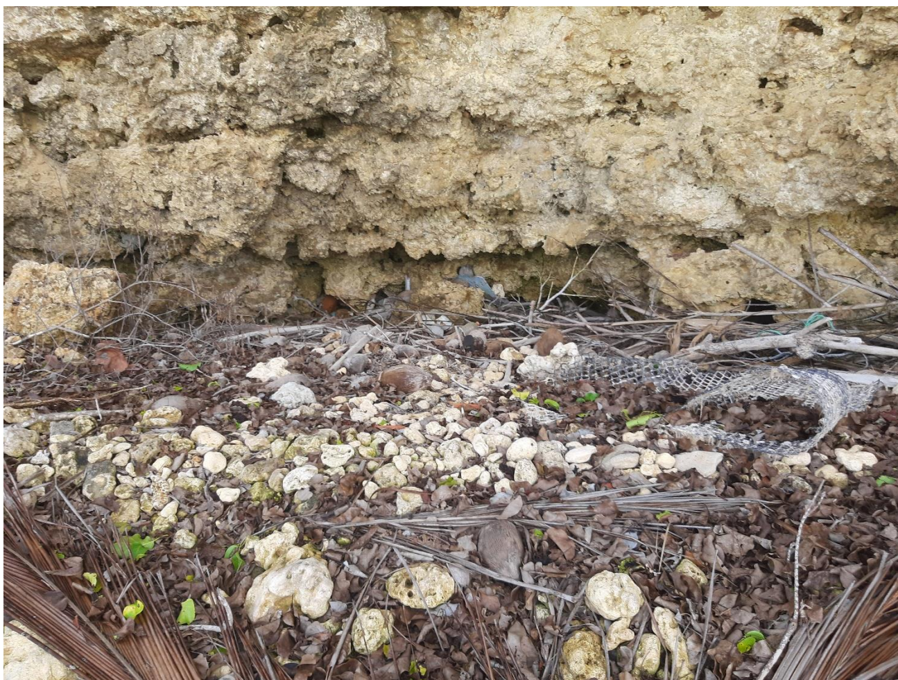
Photo 6 : Bas de la falaise, en partie Ouest. Observation d'un phénomène de sous-cavement
