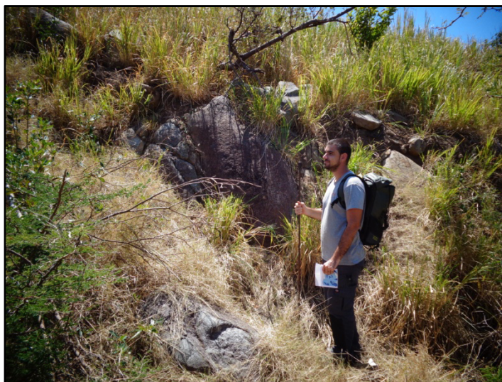
Photo n°7 : vue du talus amont bordant le chemin situé au nord de la parcelle. On observe la présence de blocs de très grande taille.
