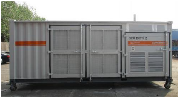
Figure 11 : Exemple d'un poste de transformation (conteneur maritime)
