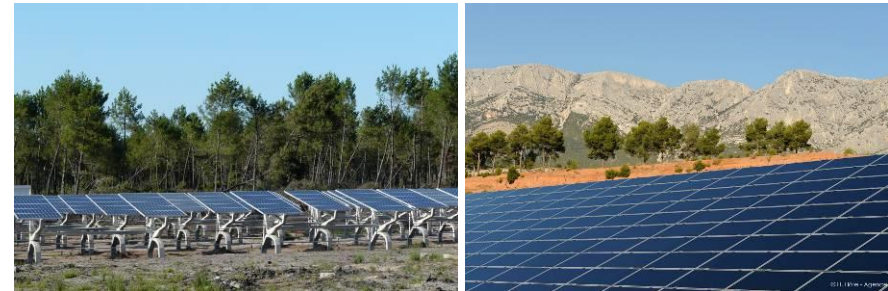
Photographie 1 : Structures solaires (à gauche: les trackers de la centrale de Gabardan (40) qui suivent le soleil ; à droite : structures fixes à Puylobier (13)) - Source : EDF EN
