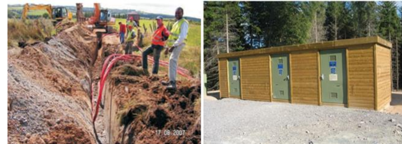
Photographie 6 : pose des câbles (à gauche), exemple de poste de livraison (à droite)
