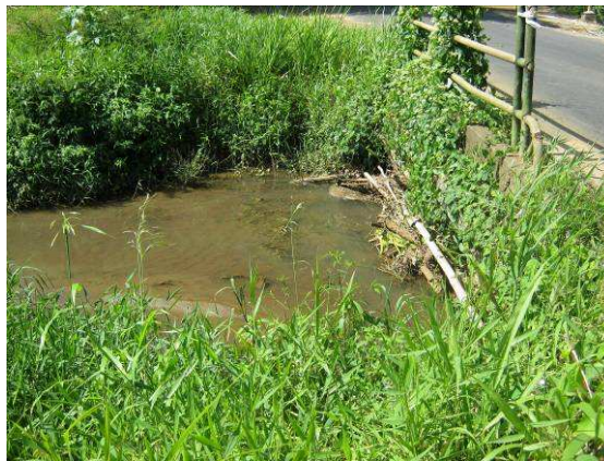
Figure 25 : Photographie de l'amont de l'ouvrage n°1 (présence d'embâcles)
