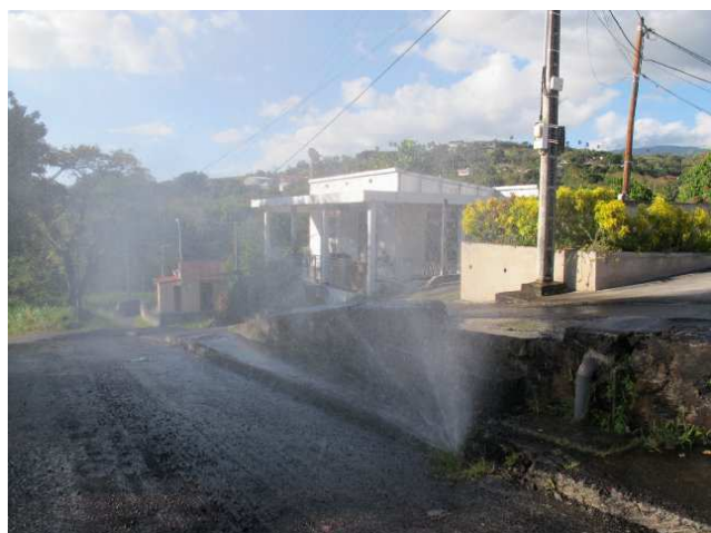
Illustration 6 : Fuite sur une conduite d'AEP (DR)
