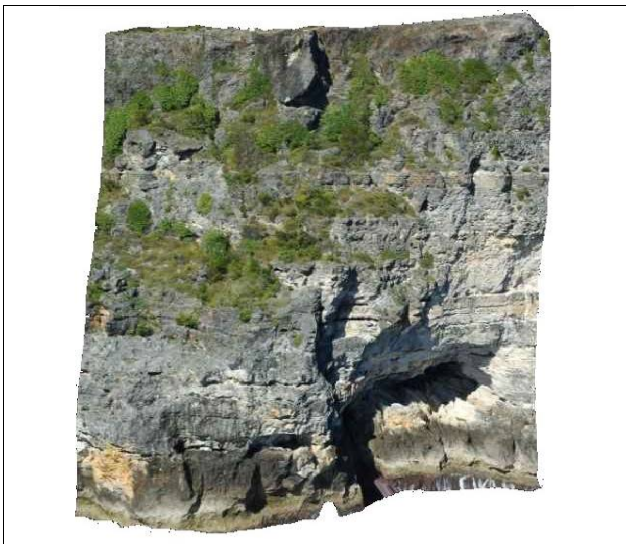
L'instabilité de la falaise à Grande Vigie. On discerne en bas, à gauche le sous cavage important créé par la dissolution sous l'effet de la mer, et en haut la masse instable dangereuse à court terme.
