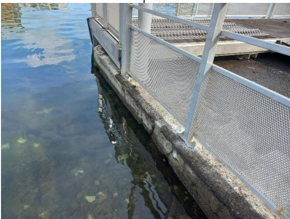
Dalle béton de la plateforme basse à conforter
