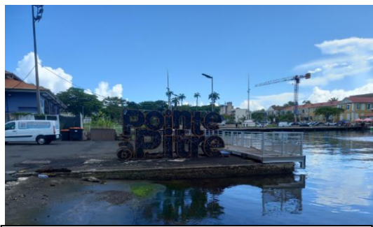
Dalle béton de la plateforme basse à conforter
