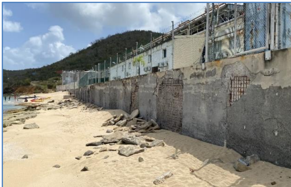
Photographie 1 – Vue générale du mur front de mer et des dégradations du béton
