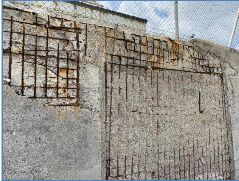
Photographie 2 – Vue rapprochée des dégradations du béton
