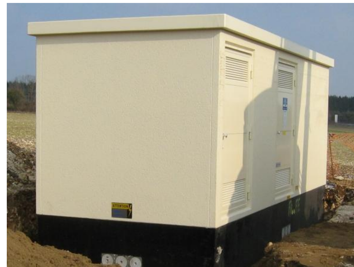
Illustration 20 : Façade du poste de livraison
