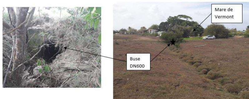
Figure 58 : Localisation de la buse se rejetant dans la mare de Vermont (21/06/2022)
