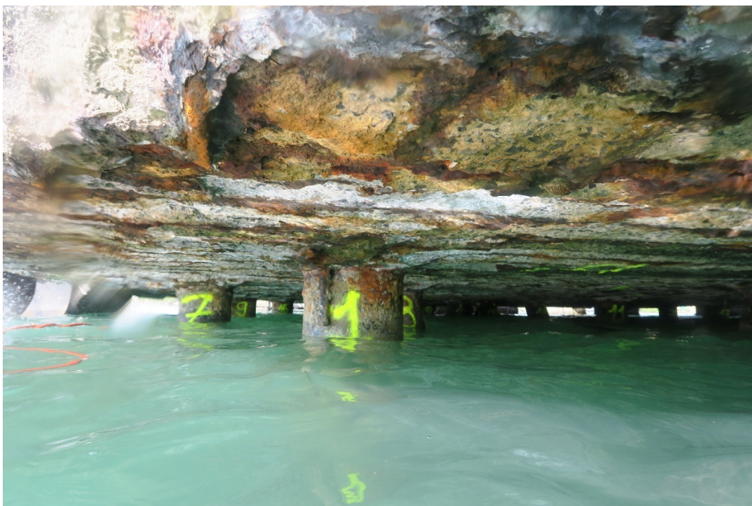
Figure 3 : Eclatement du béton en sous-face et disparition de la nappe d'acier inférieure (Rapport D'inspection AMAYA du 30 novembre 2019)
