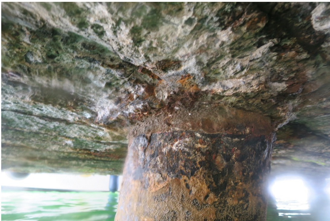
Figure 2 : Etat général des pieux et sous-face des édicules (Rapport D'inspection AMAYA du 30 novembre 2019)
