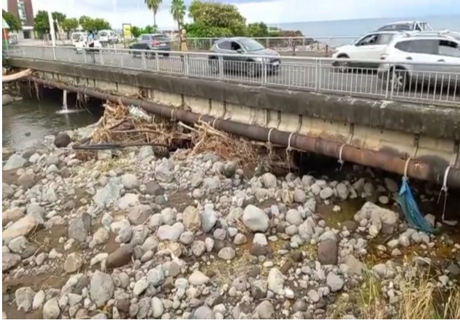
Embâcles et atterrissements pouvant aggraver le risque d'inondation et endommager les canalisations d'eau usées (Rivière aux herbes BT)
