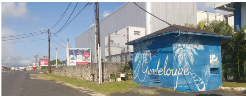
Accotement à restructurer. Absence de délimitation de l'accotement entrainant des conflits d'usages. Caniveau béton sous dimensionnés.
