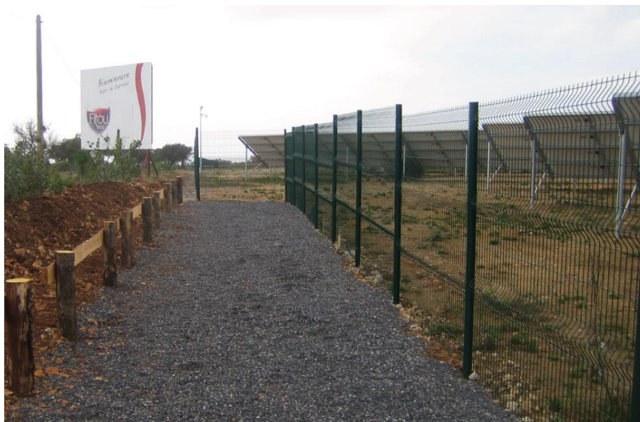
Figure 51 : Exemple de clôture d'enceinte d'une centrale solaire photovoltaïque au sol
