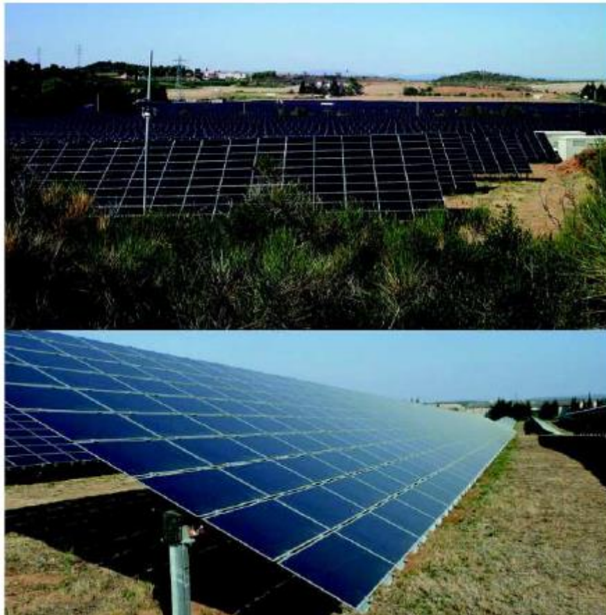
Figure 50 : Exemple de centrales photovoltaïques au sol vues de face et de profil
