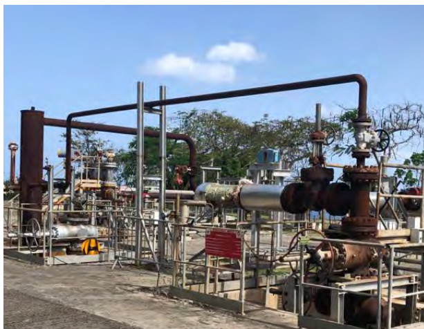
site géothermique de Bouillante / © DEAL Guadeloupe
