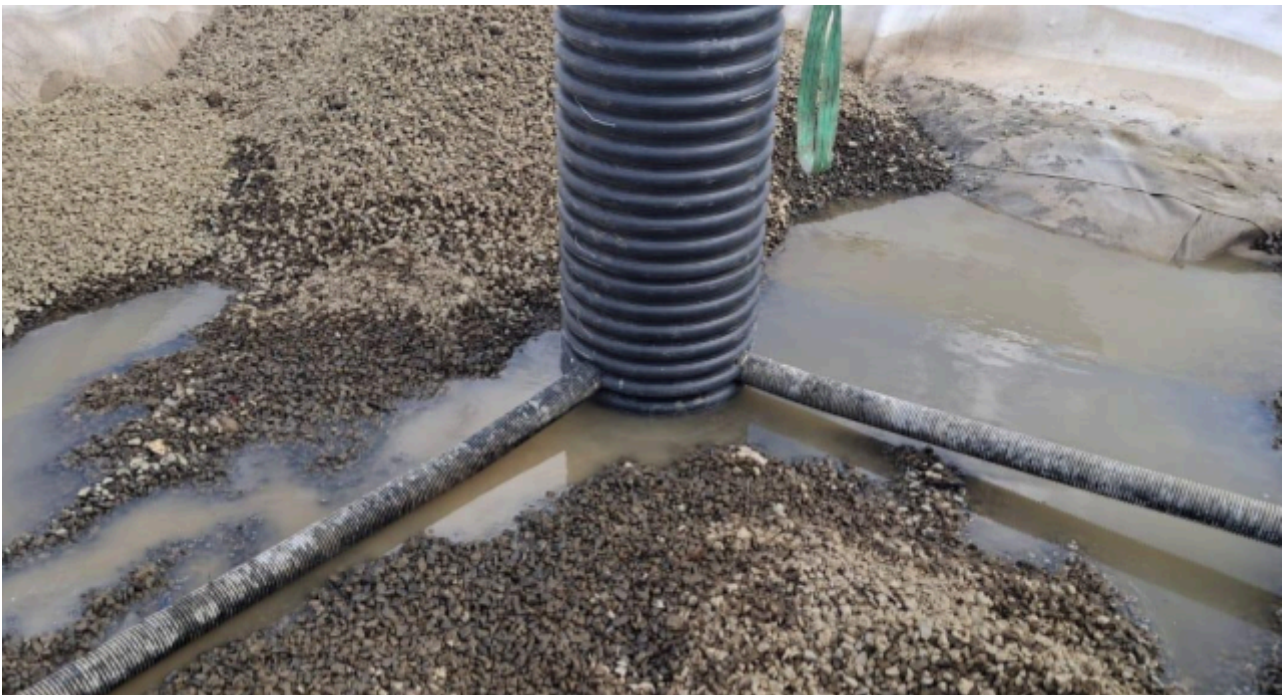
Figure 17 : Aménagement de la gestion lixiviat dans le point bas du CASIER 10
