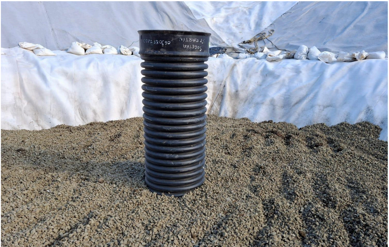
Figure 18 : Puits mixte lixiviat / Biogaz - Casier 10
