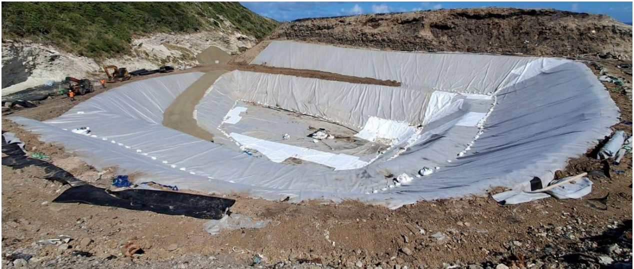
Figure 16 : Barrière de sécurité active sur le Casier 10
