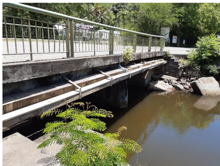
Figure 13 : Pont en état « dégradé » observés en 2022 (Rivière Deshaies)
