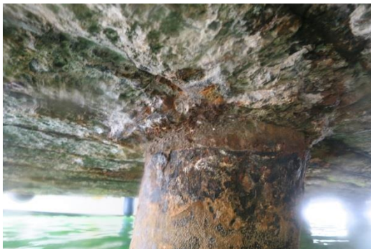
Figure 2 : Etat général des pieux et sous-face des édicules (Rapport D'inspection AMAYA du 30 novembre 2019)
