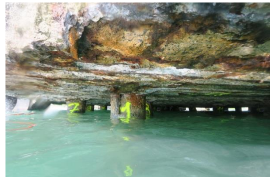
Figure 3 : Eclatement du béton en sous-face et disparition de la nappe d'acier inférieure (Rapport D'inspection AMAYA du 30 novembre 2019)
