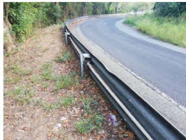
Glissière de sécurité à l'extérieur du virage, vue en direction de Morne-à-Jules
