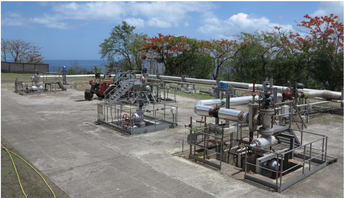
Figure 18 : Vue générale de la plateforme actuelle de Plateau illustrant une plateforme d’exploitation de puits géothermiques. A noter que cette plateforme comporte 4 têtes de puits (BO-4, BO-5, BO-6, BO-7) alors que les nouvelles plateformes des puits BO-11 et BO-12 ne comporteront qu’un seul puits.
