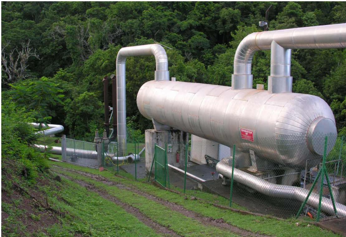
Figure 20 : Vue du ballon séparateur eau/vapeur Haute Pression existant qui sera remplacé par un ballon séparateur plus grand pour prendre en compte le surcroît de fluide qui sera apporté par le puits BO-12.
